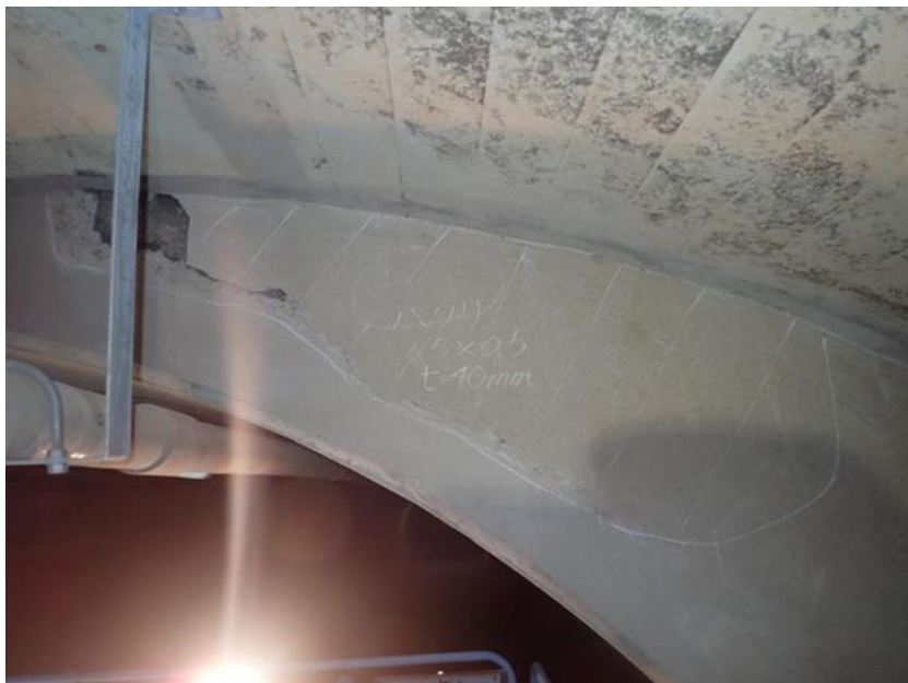
トンネル妻部：ひび割れを伴ううき
