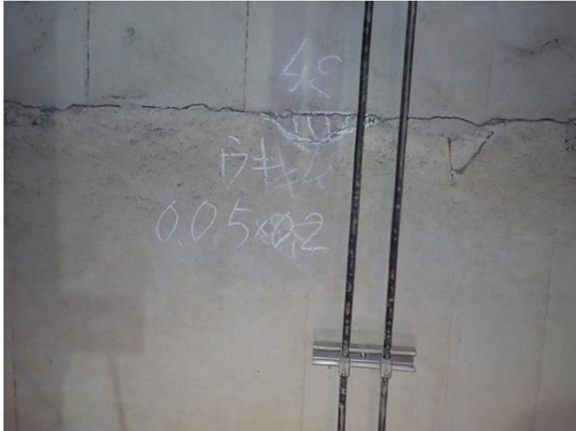
損傷具合：横断目地のうき
